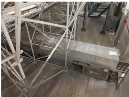
Tunnel di uscita prodotto
