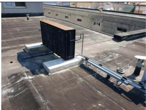
Evaporatore cella pesce
