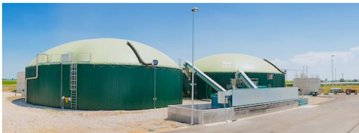
Figura 21 - Esempio di digestori anaerobici
