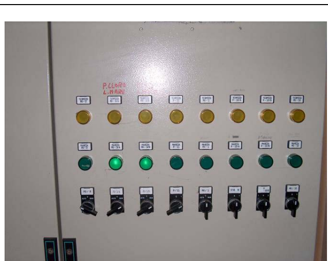
Foto 16– QUADRI ELETTRICI DI CONTROLLO
