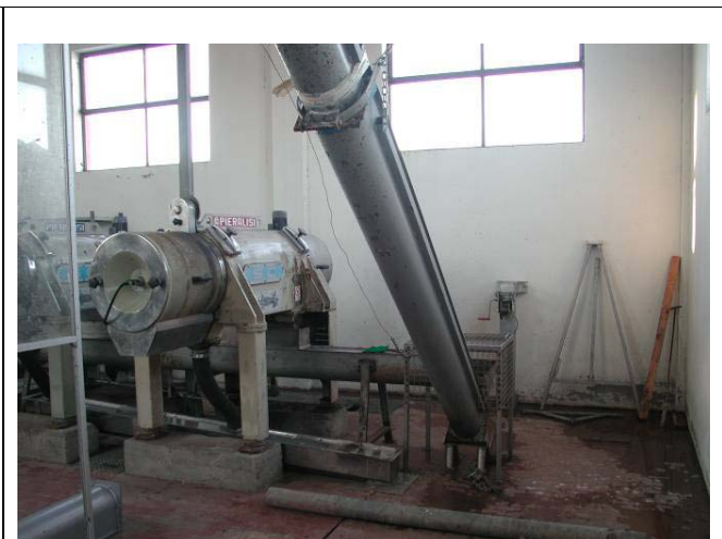
Foto 16– CENTRIFUGHE PER DISIDRATAZIONE
