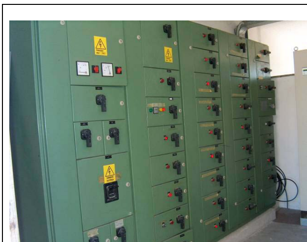
Foto 15– QUADRI ELETTRICI DI POTENZA
