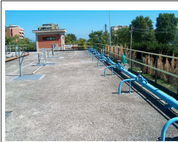
Foto 5 – OSSIDAZIONE NITRIFICAZIONE NELLA ZONA CENTRALE DELLA VASCA
