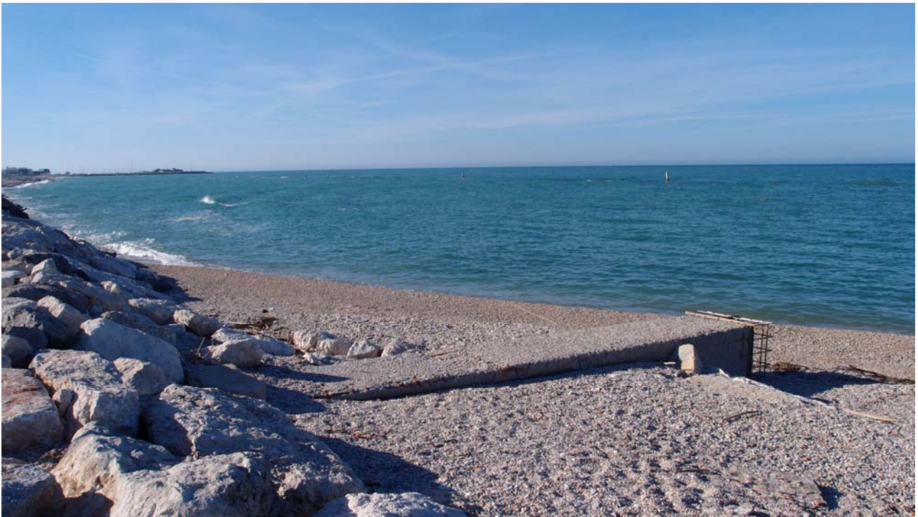
Foto 4.3/1 - Lo scolmatore di Via Ruggeri. Punto di uscita.
