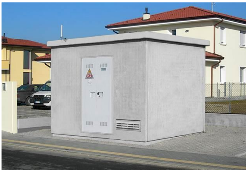
Figura 27 - Cabina elettrica di distribuzione
