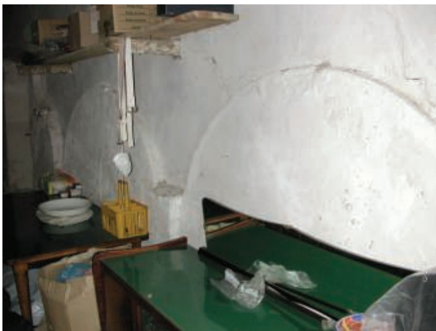
3.3 Resti dell'imposta delle volte di copertura del fortilizio, al primo piano dell'attuale edificio .
